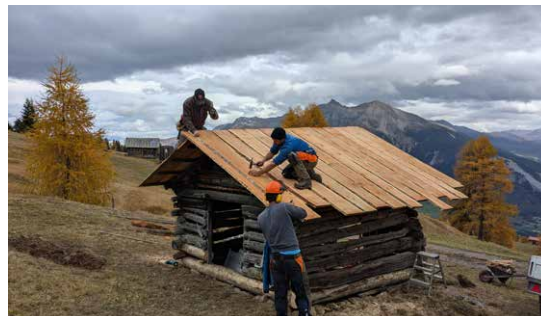
Neueindeckung des Daches von Objekt A_20 in Tgamons Bargiaglia oberhalb von Stierva
